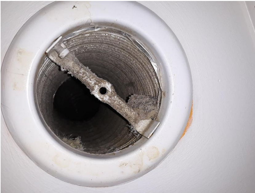
Kuva. Puhdistamaton poistoilmanvaihtokanava
